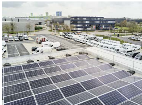
Ausreichend Platz auf 55.000 m 2 . Die Dachflächen wurden für 1.900 Photovoltaik-Module genutzt.
